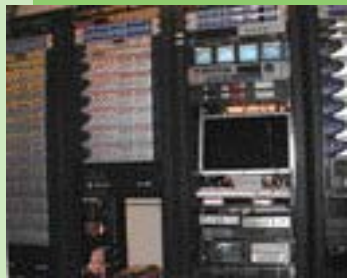
コントロールルーム
